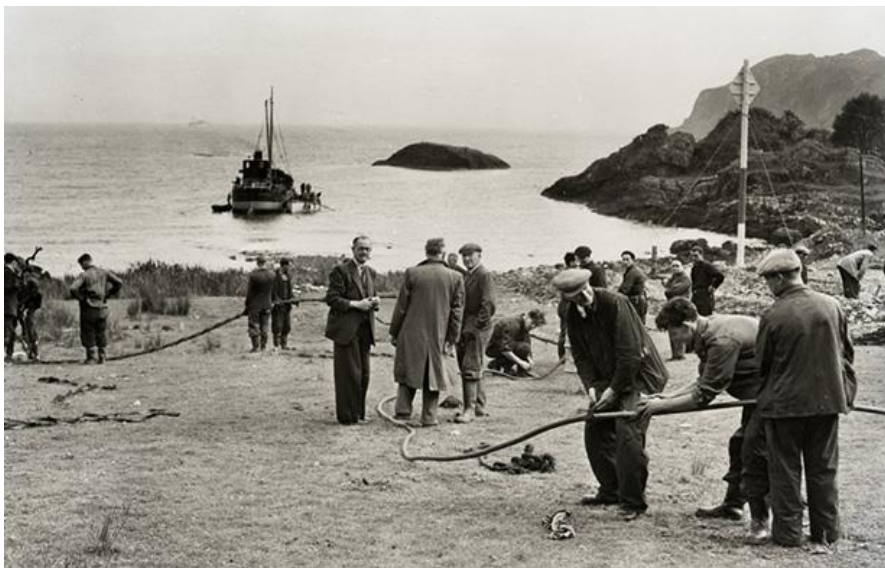
Installation du câble Transatlantique téléphonique TAT1, Oban, Scotland, 1955. Image de BT Heritage & Archives
